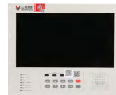
消防控制室图形显示装置
